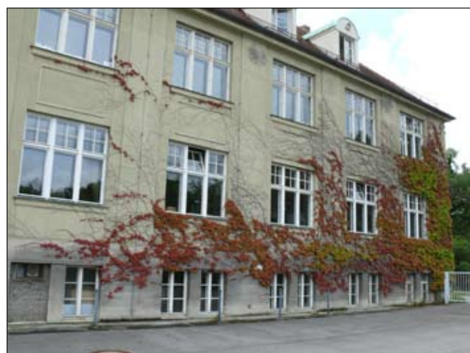
Abb. 8b: 3.8.2012: Westlicher Flügel der Nordfassade des Botanischen Institutes mit teilweise abgestorbenem und vorzeitig rot gefärbtem Wildem Wein. Auf die Nordfassade treffen aus ca. 150 m Entfernung Hochfrequenzmissionen ausgehend von den Mobilfunksendeanlagen des Eichamtes auf. Die Hochfrequenzmessung ergab 4.980 \mu\text{W}/\text{m}^2 (Foto: C. Waldmann-Selsam).
